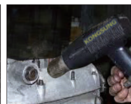
Désserrer les écrous et boulons rouillés Loosen Rusted Nuts & Bolts
